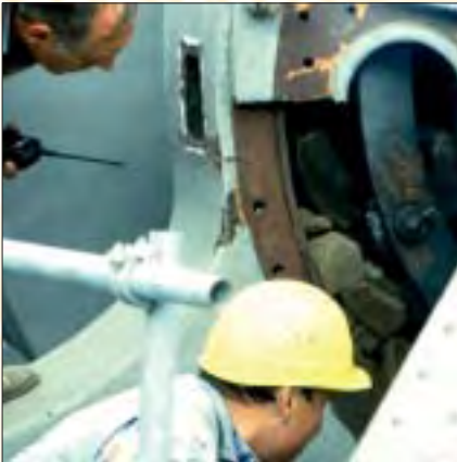
▲ Blick in das zerstörte Lager.
