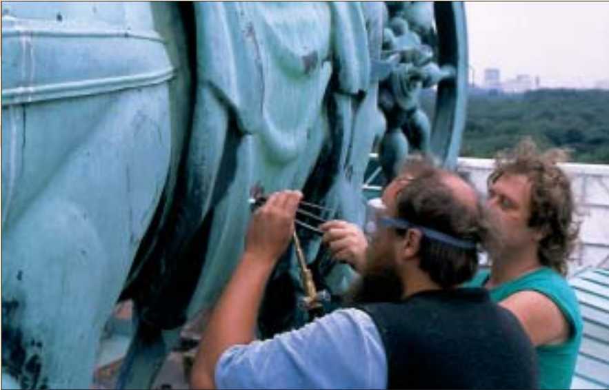
▲ Remontage der Quadriga auf dem Brandenburger Tor im Juli 1991 nach 2-jähriger Restaurierung im Deutschen Technikmuseum. Foto: DTM
